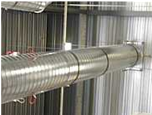
Funkenerkennung und Löschdüsen sind rohgasseitig der Filteranlage vorgeschaltet
