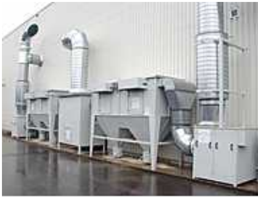
Filterzentrale einer Patronenfilteranlage mit einem Volumenstrom von 20.000 m 3 /h und Funkenfalle
